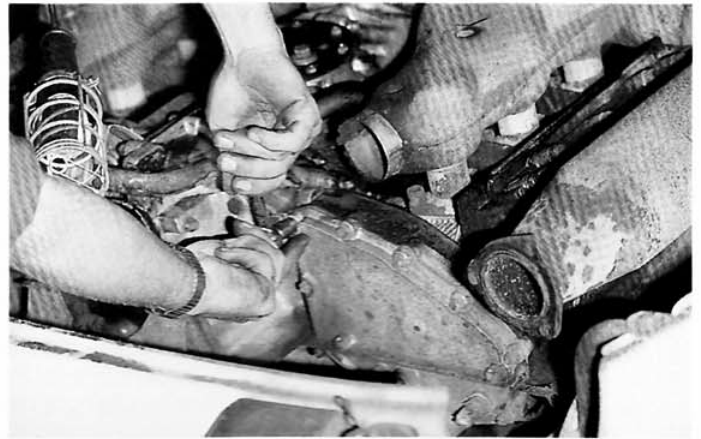
18. Tous les accessoires retirés, vous pouvez déposer les carters de distribution. Lors du remontage, utilisez de la nouvelle boulonnerie.
